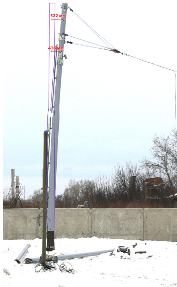
Деформация опоры без подкоса ( F=7,3 кН)
