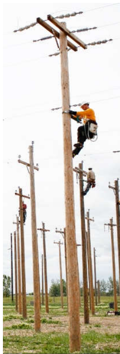
Деревянные опоры 6-20 кв – 15-50 лет
