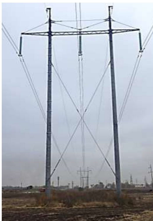
ПБ330-7(с) на ВЛ 330 кВ Южная – Садовая
