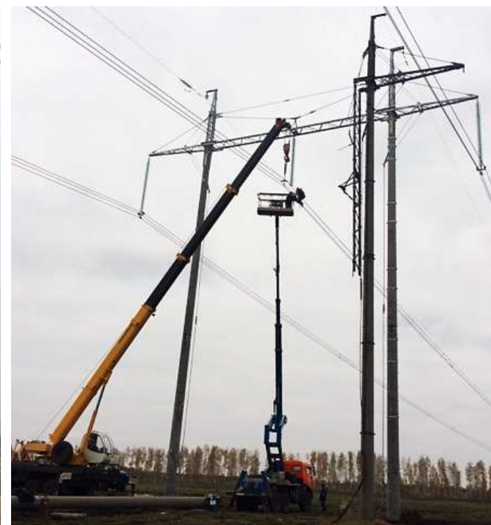
ПБ500-5н(с) на ВЛ 500 кВ Тамбов – Пенза-2
