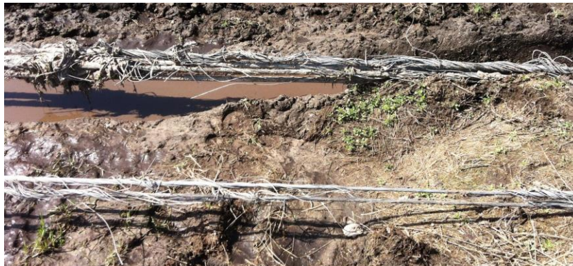
Рис.1. Падение 12 опор на оттяжках типа П750-1 на ВЛ 750 кВ «Курская АЭС – Новобрянская» . 28.04.2013 из-за сверхнормативных ветровых нагрузок
