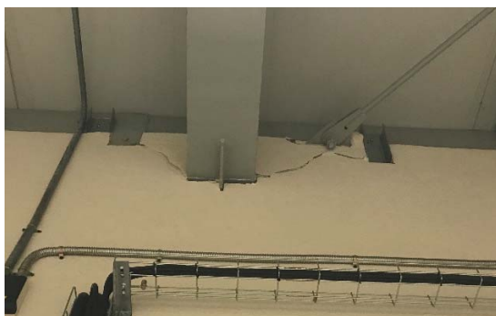
Фото 1. Трещины в районе несущей балки
