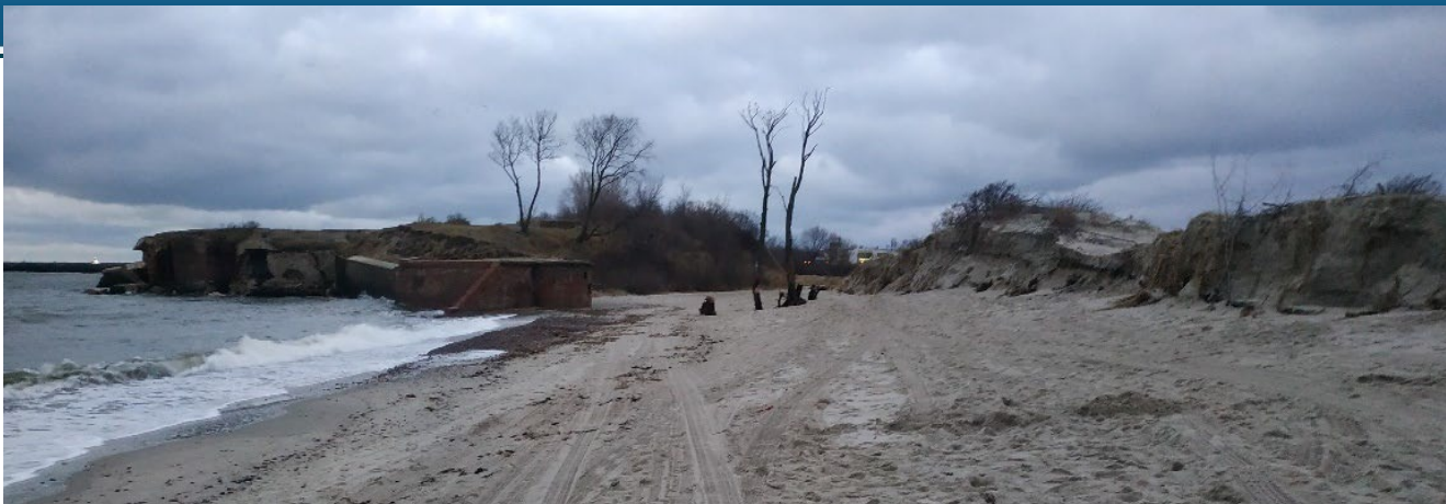
Аварийный участок берега на Балтийской косе в феврале 2022 года
