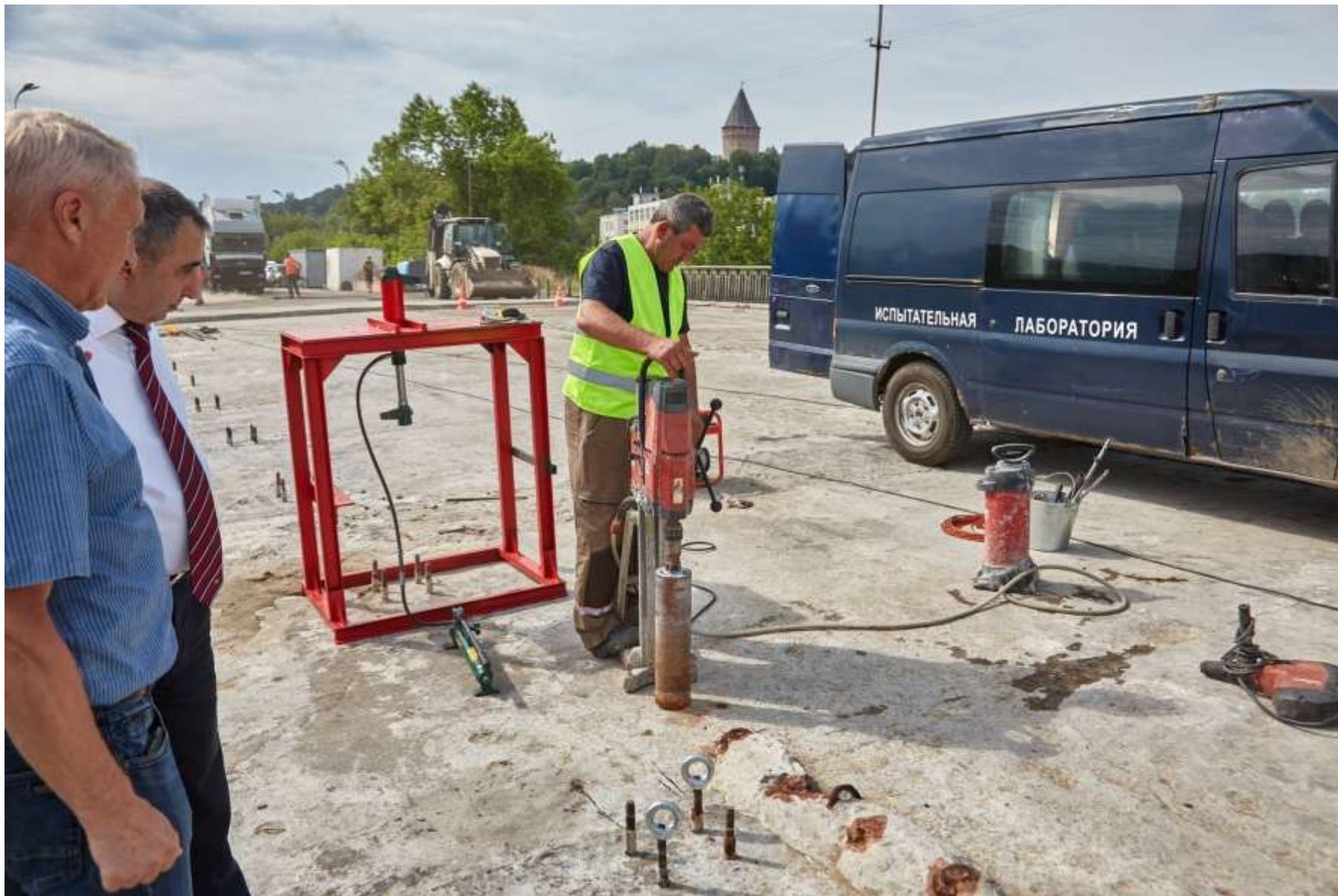
ОБСЛЕДОВАНИЕ КРЕСТОВОЗДВИЖЕННОГО МОСТА ЧЕРЕЗ Р. ДНЕПР В Г. СМОЛЕНСКЕ ПРИ ЕГО РЕМОНТЕ, 2022 Г.
