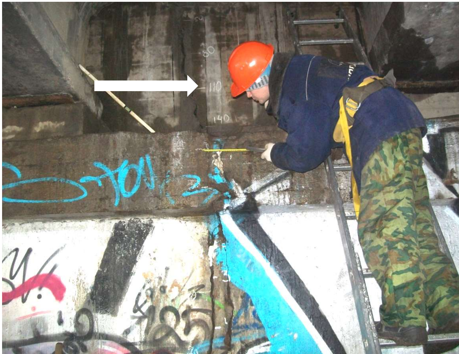
Трещина на ригеле и шкафной стенке
