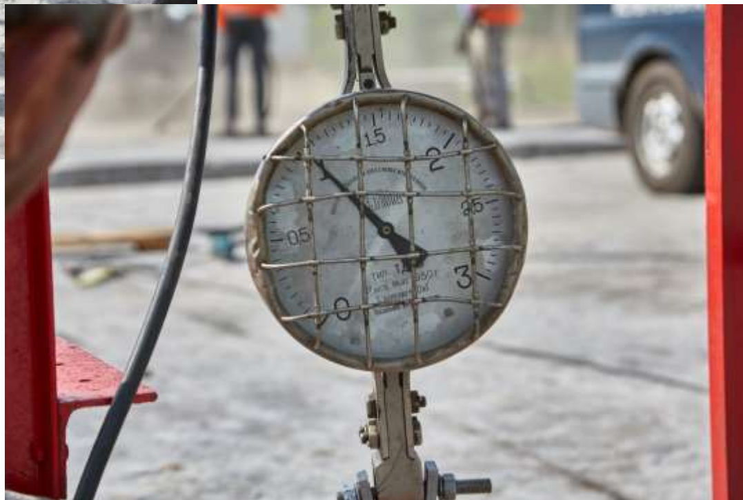
ОБСЛЕДОВАНИЕ КРЕСТОВОЗДВИЖЕННОГО МОСТА ЧЕРЕЗ Р. ДНЕПР В Г. СМОЛЕНСКЕ ПРИ ЕГО РЕМОНТЕ, 2022 Г.
