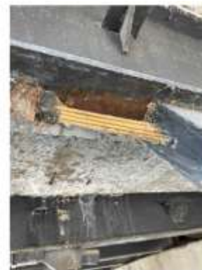
Фото Г.12 – Разрушение и участки нарушения целостности стержня АСК
