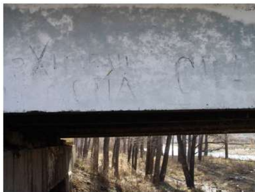
Рис. 6. Вид на концевой участок балки с преднапряженной АСП. При тщательном исследовании боковой поверхности балок в натуре трещин не обнаружено
