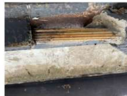
Фото Г.19 – Разрушение и участки нарушения целостности стержней АСК. Отслоение окрасочного покрытия и поверхностная коррозия металлических конструкций
