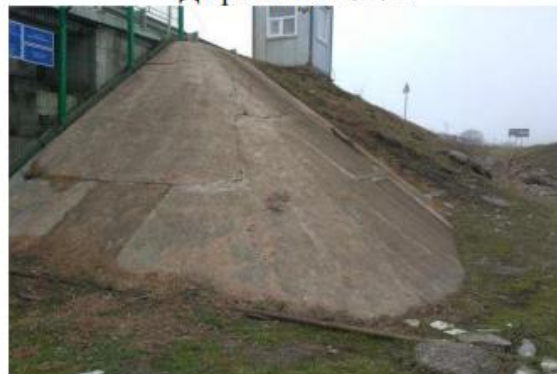
До ремонта 2017 г.
