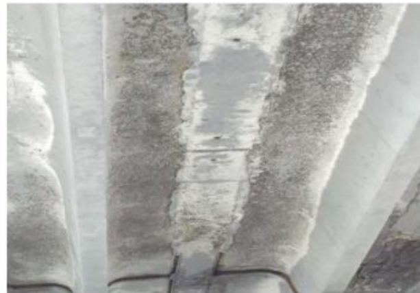
До ремонта 2017 г.
