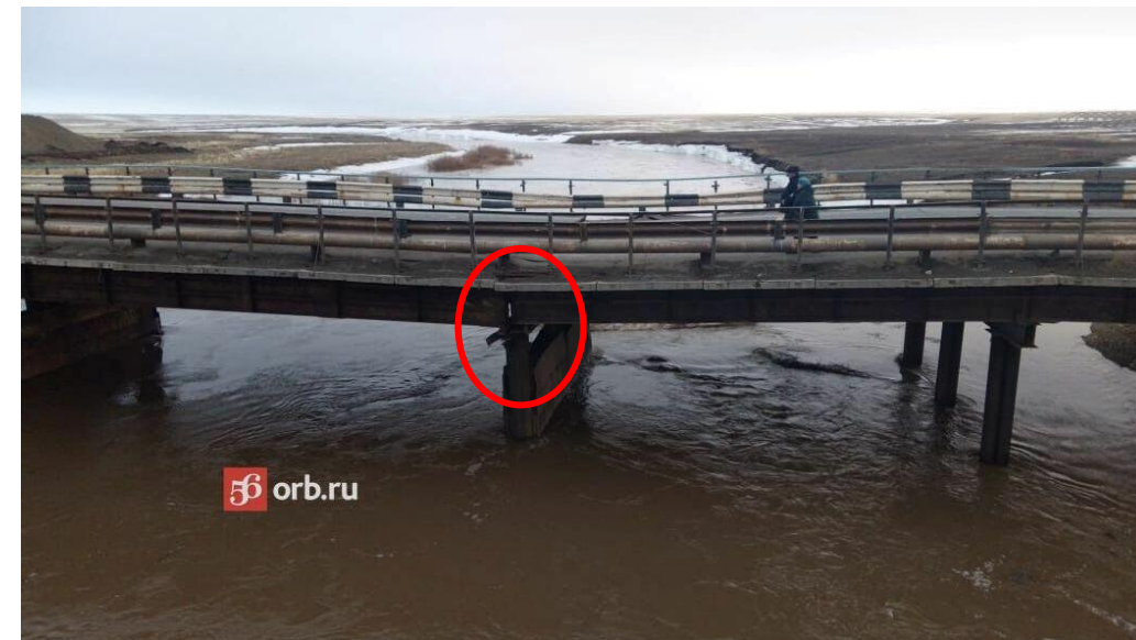
Разрушение моста ч/з реку Жуса (Оренбургская обл., март 2023г)
