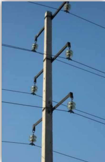
ВЛ 10 кВ с изоляторами ПС 70Е
