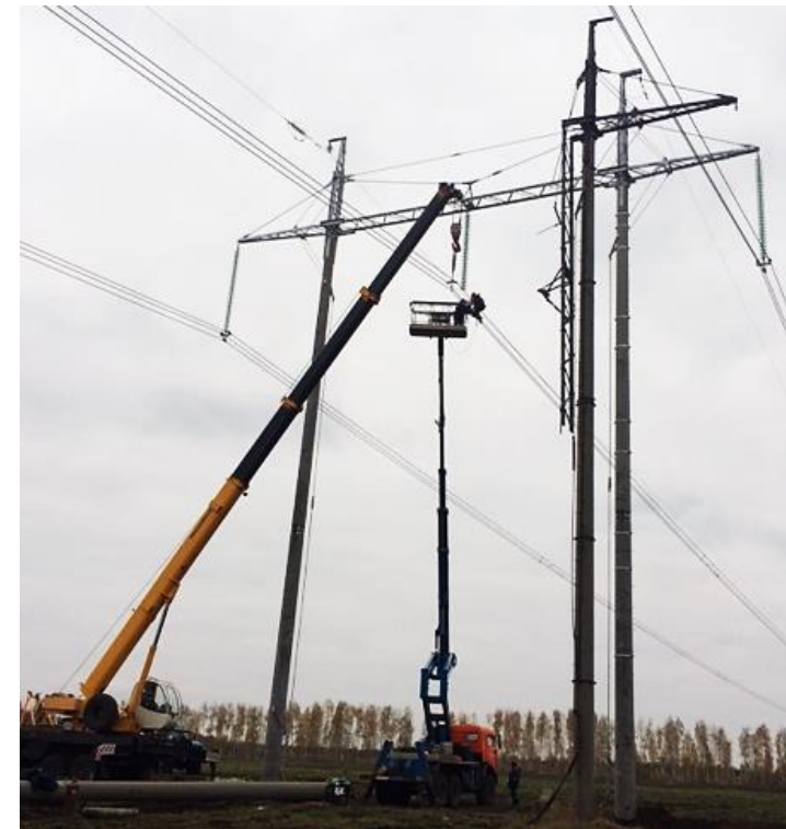
ПБ500-5н(с) на ВЛ 500 кВ Тамбов – Пенза-2
