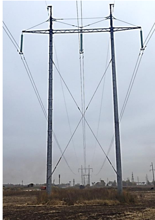
ПБ330-7(с) на ВЛ 330 кВ Южная – Садовая
