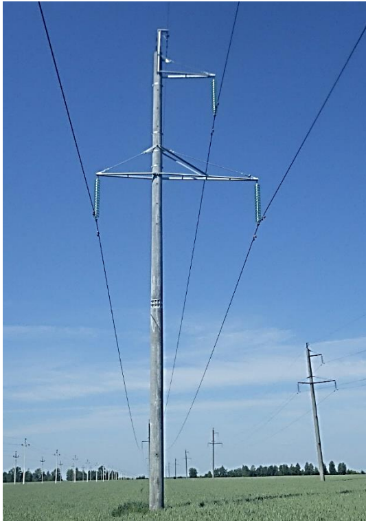
ПБ220-1(с) на ВЛ 220 кВ Тамбовская – Иловайская
