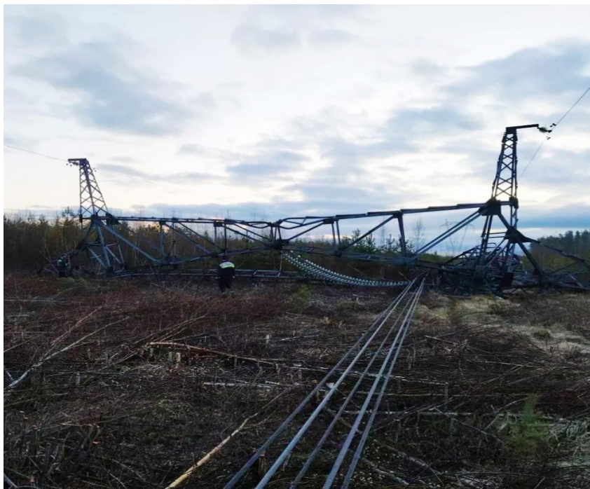
Рис. 3. Терроризм : порталная опора 750 кВ типа «Набла» со стойками, поврежденными взрывом (Ленобласть, 01.05.2023, фото А.Д.Дрозденко)
