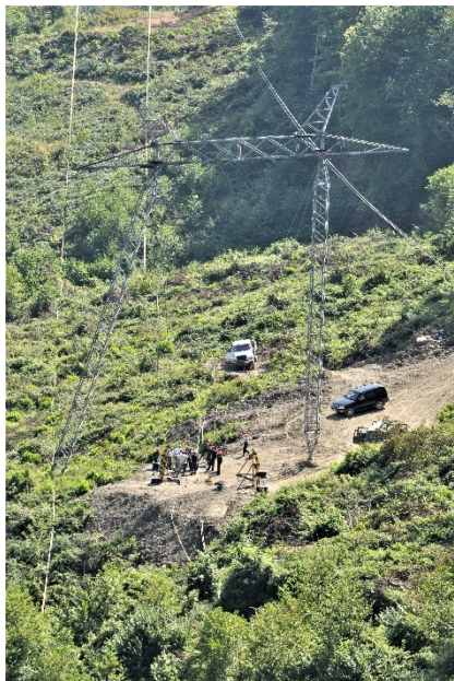
Рис. 8. Аварийное повреждение опоры ВЛ 500 (220) кВ от оползня
