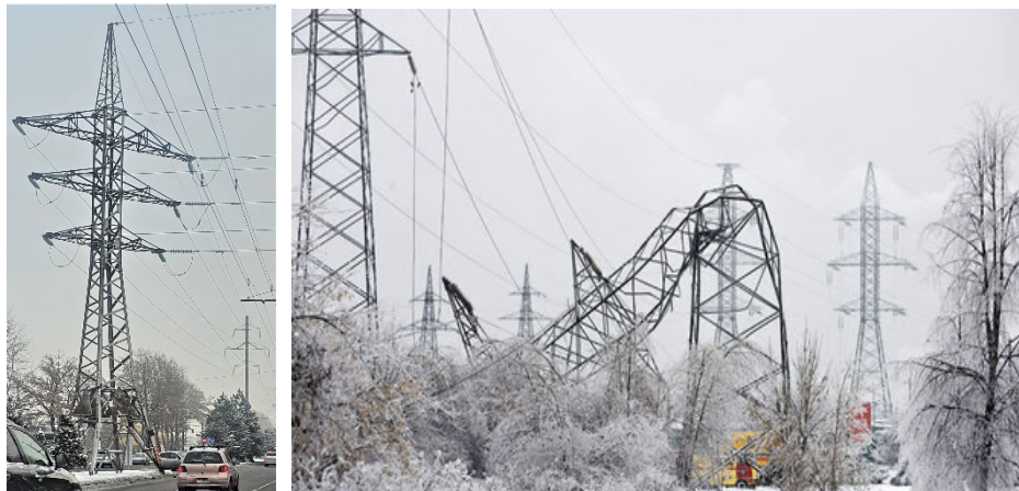
Рис.6 Конструкции опор ВЛ220кВ: предаварийное состояние (Бишкек, 2021); гололедно-ветровая авария в Подмоскowie (2020)
