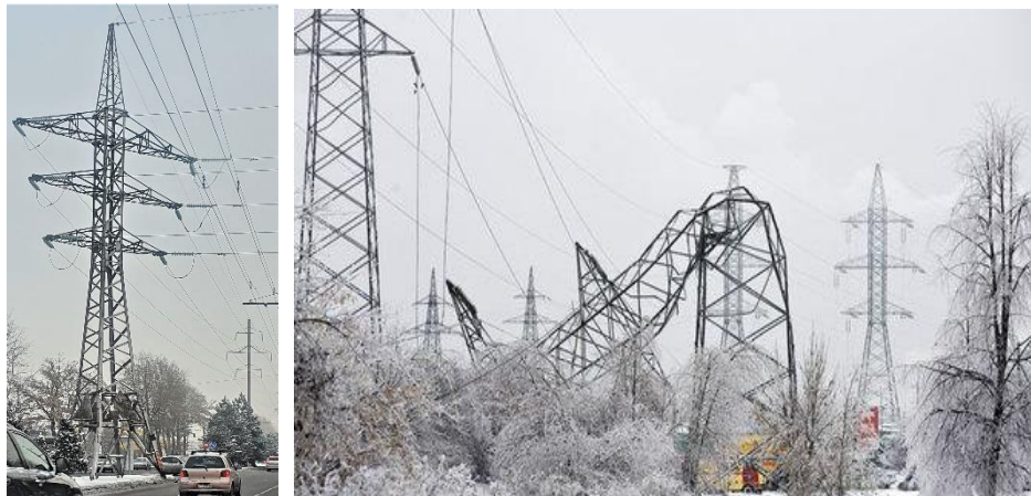
Рис.1 Конструкции опор ВЛ220кВ: предаварийное состояние (Бишкек, 2021); гололедно-ветровая авария в Подмосковье (2020)
