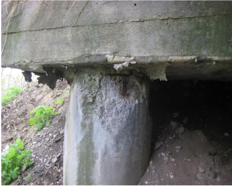
Опора 1. Столб №8. Зона сопряжения с ригелем. Скол бетона с обнажением и коррозией арматуры. S=0,30 \text{ м}^2 (мост через р. Ериловка на 7+015 автомобильной дороги общего пользования регионального значения Вербилово-Грязное-Боринское в Липецком районе Липецкой области)
