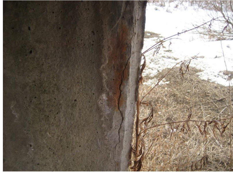
Опора 4. Свая №1. Вертикальная трещина с шириной раскрытия до 3 мм. Вид со стороны опоры 5 (мост через реку Лебедянка на км 38+873 автомобильной дороги Доброе - Трубетчино - Вязово - Лебедянь в Лебедянском районе Липецкой области)
