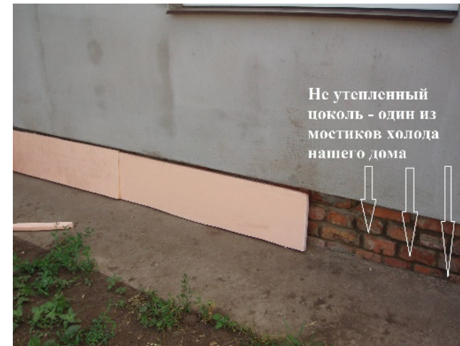
Наличие теплопроводных включений (мостиков холода)
