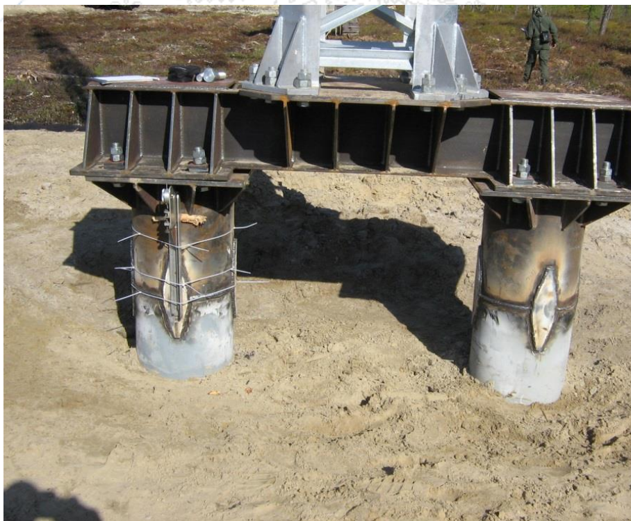
Одностоечная опора на двухсвайном бурозабивном фундаменте
