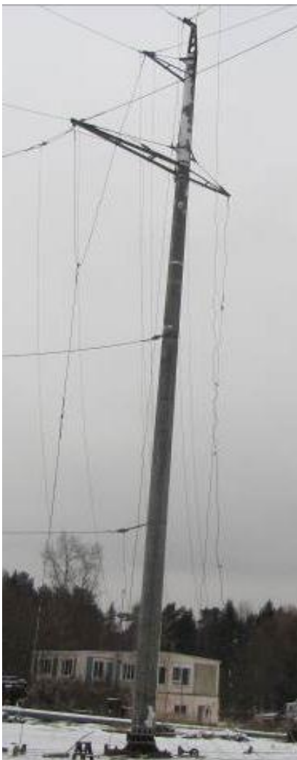
Одноцепная промежуточная повышенная опора
