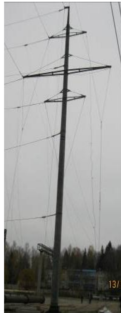
Двухцепная промежуточная повышенная опора
