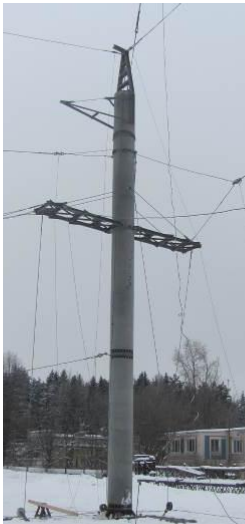
Одноцепная анкерно-угловая опора
