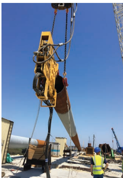
Рис. 3. Подъем сваи-оболочки диаметром 1420 мм, длиной 85м, с установленным вибропогружателем АРЕ-250VM на стапеле
