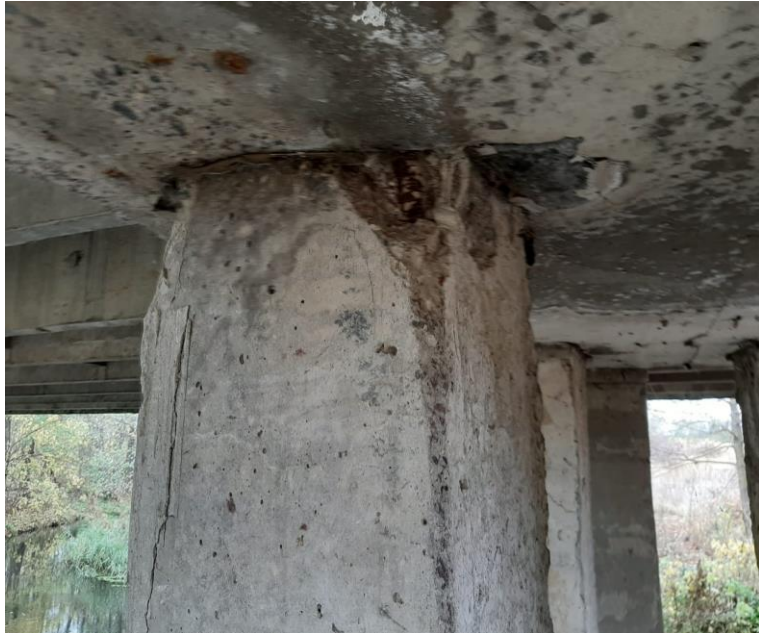
Опора 3. Свая № 3. Ряд свай №1. Разрушение бетона в месте сопряжения сваи с насадкой (мост через реку Делеховка на км 21+851 автомобильной дороги Липецк-Доброе-Чаплыгин с подъездом к с. Филатовка в Добровском районе Липецкой области)
