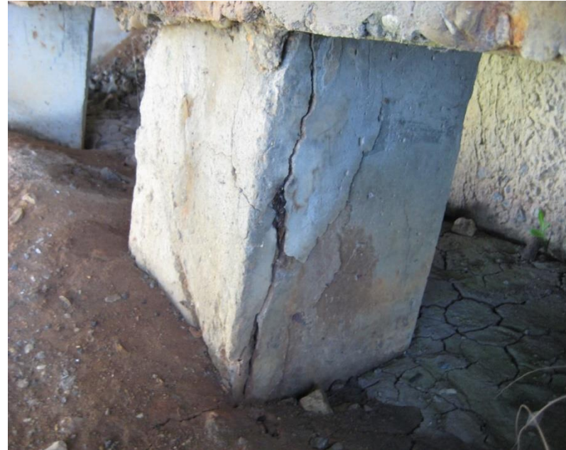
Опора 1. Ряд свай №2. Свая 2. Разрушение защитного слоя бетона. Вертикальная трещина с шириной раскрытия до 6 мм (мост через р. Пальна на км 15+110 автомобильной дороги общего пользования регионального значения Становое-Троекурово-Лебедянь в Становлянском районе Липецкой области)
