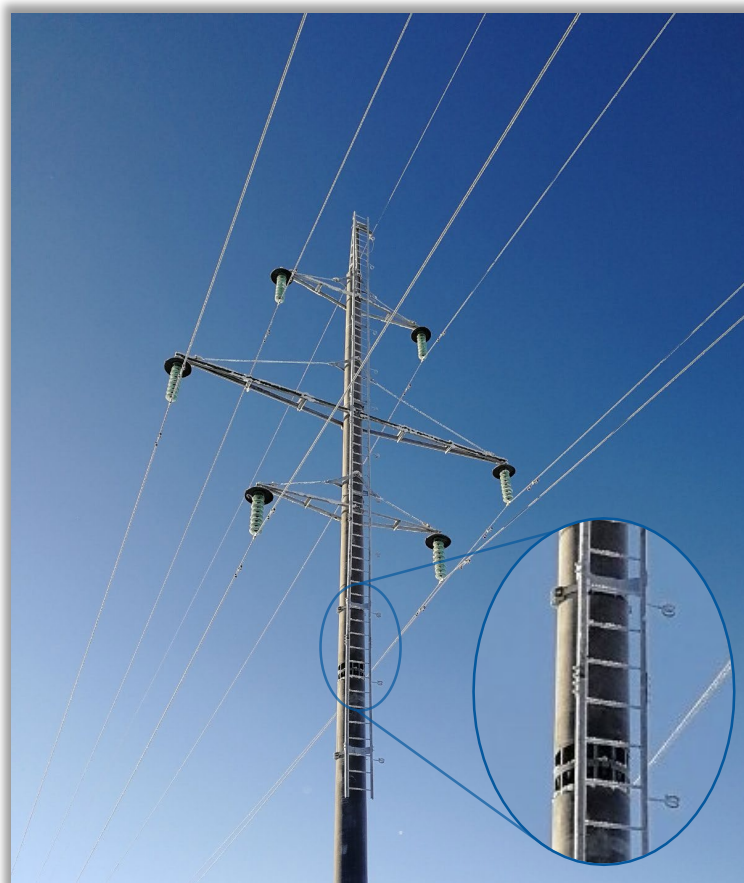
Рисунок 4 – Промежуточная опора СПБ110-2 с лестницей, снабженной анкерными петлями, на ВЛ 110 кВ в Республике Башкортостан
