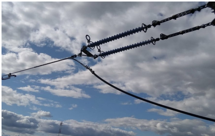
Шлейф изолированный Индикаторы пробоя изоляции
