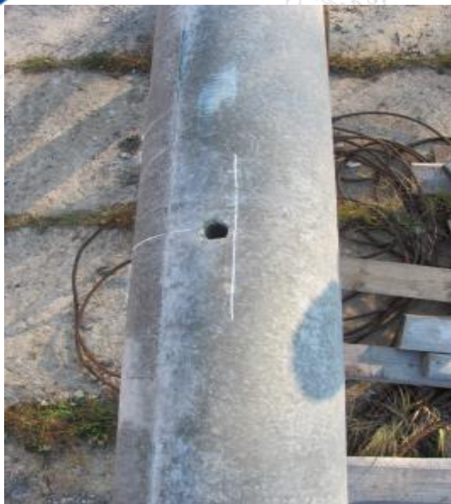
Отклонение закладной от оси стойки
