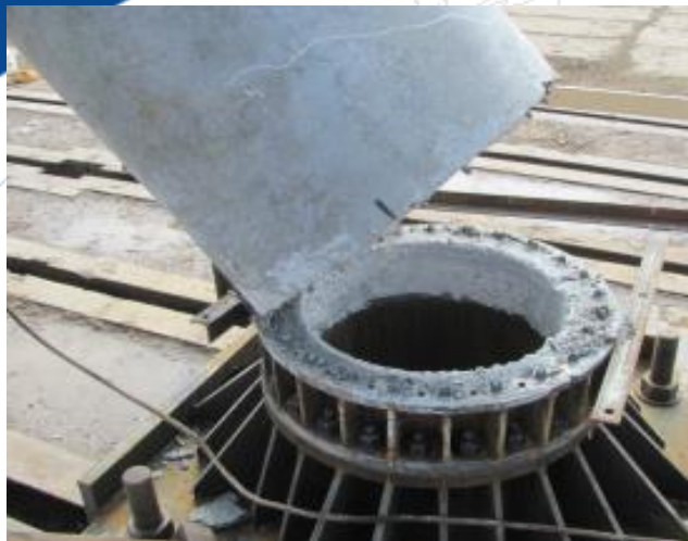
Разрушение стойки СЦС20 В40.1 (152%)
