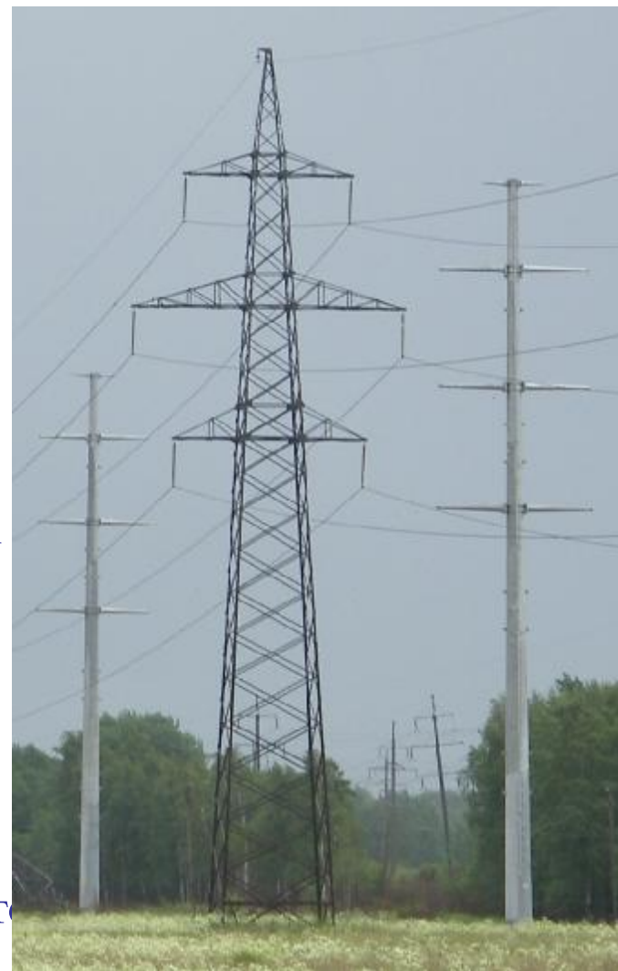
ВЛ 330 кВ «Восточная- Волхов- Северная»
